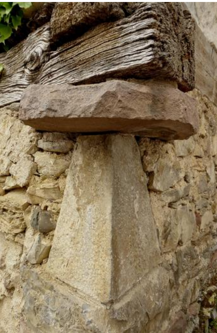
PILAR Y RODEZNO IZQUIERDO DEL LADO NORTE
