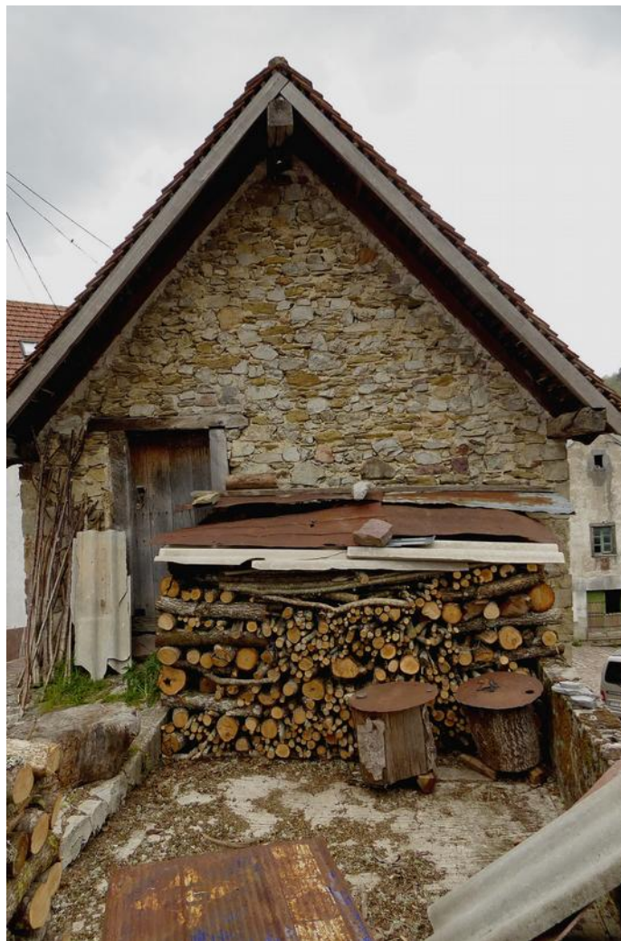
LADO OESTE DONDE NO SE APRECIA NINGÚN PILAR NI RODEZNO.
